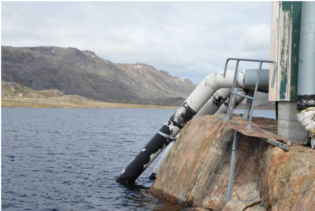
Figur 4-2. På figuren ses indvindingspunktet for råvand for vandværket. Ledningen går nogle meter ud i søen. Indvindingspunktet findes tæt på land på et næs, som stikker lidt ud i Vandsø 5.
