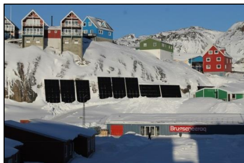
Som led i Bæredygtighedsprojektet blev der med støtte fra Selvstyrets VEK-pulje opsat et stort solcelleanlæg på en klippevæg ved plejehjemmet Neriusaaq.
